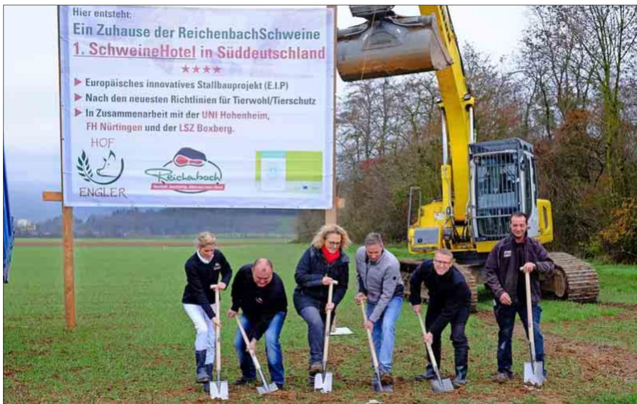
Sonja und Ulrich Reichenbach, Kirsten und Andreas Engler, Bürgermeister Johannes Ackermann und Tiefbauer Stephan Ruhland (von links) beim Spatenstich
